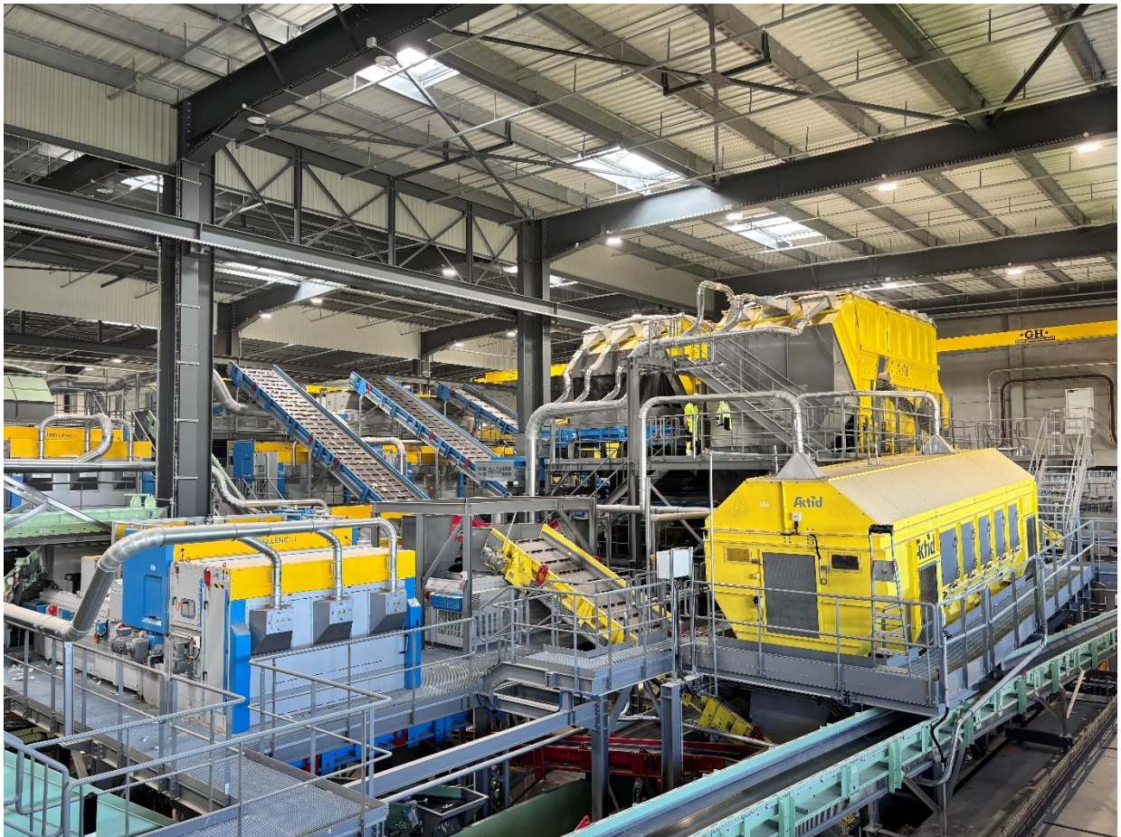
Process du nouveau centre de tri performant de Bessières, VALCOPIA
