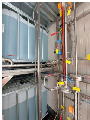
Fig 2: intérieur module de stockage et distribution d'urée
