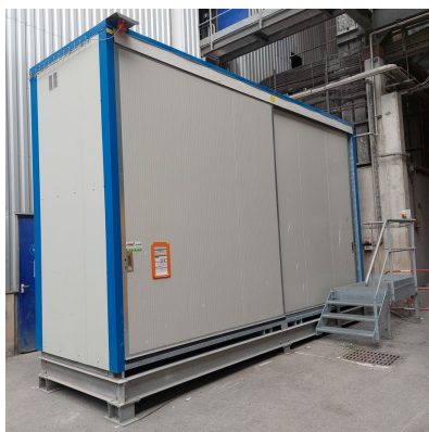
Fig 1 : module de stockage et distribution d'urée
