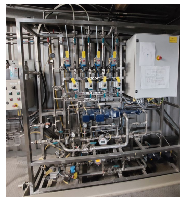
Fig 3: Skid de régulation
